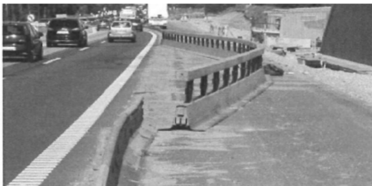
Figur 7.44 Eksempel på påkørt trafikværn med manglende forankring, overlap eller overgangsstykker.
