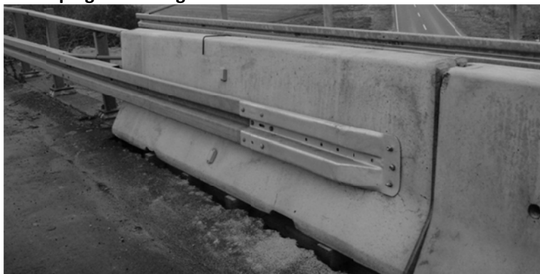
Figur 7.43 Eksempel på overgang mellem trafikværn og autoværn.!
