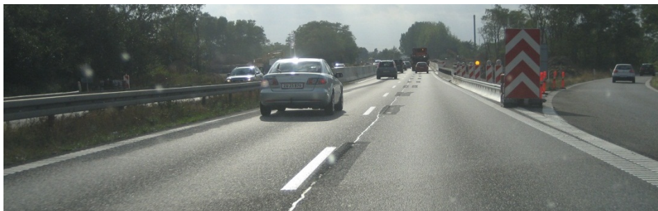
Figur 4.6 Eksempel på belægning med ar efter fjernet kørebaneafmærkning.
