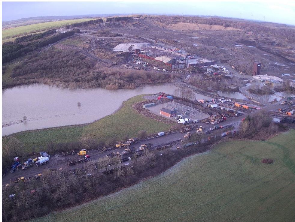
Billede 1: Området set fra sydøst. Alling Å, hvor vandet er rent, er gået over sine breder. Vandet inde på arealet er forurenat. Vandområderne er adskilt med en dæmning, som lige er opført. Der pumpes vand fra Alling Å i rør over til den eksisterende Alling Å lige syd for Ølst by. Jordskredet kan ses øverst til højre. Området ligger fra kote 75 ned til kote 20. Det har faldet mod Alling Å og landevejen Gl. Århusvej.
